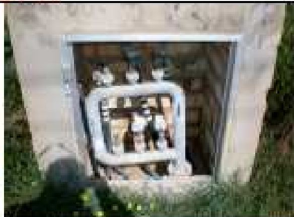
Batería de control de agua.
